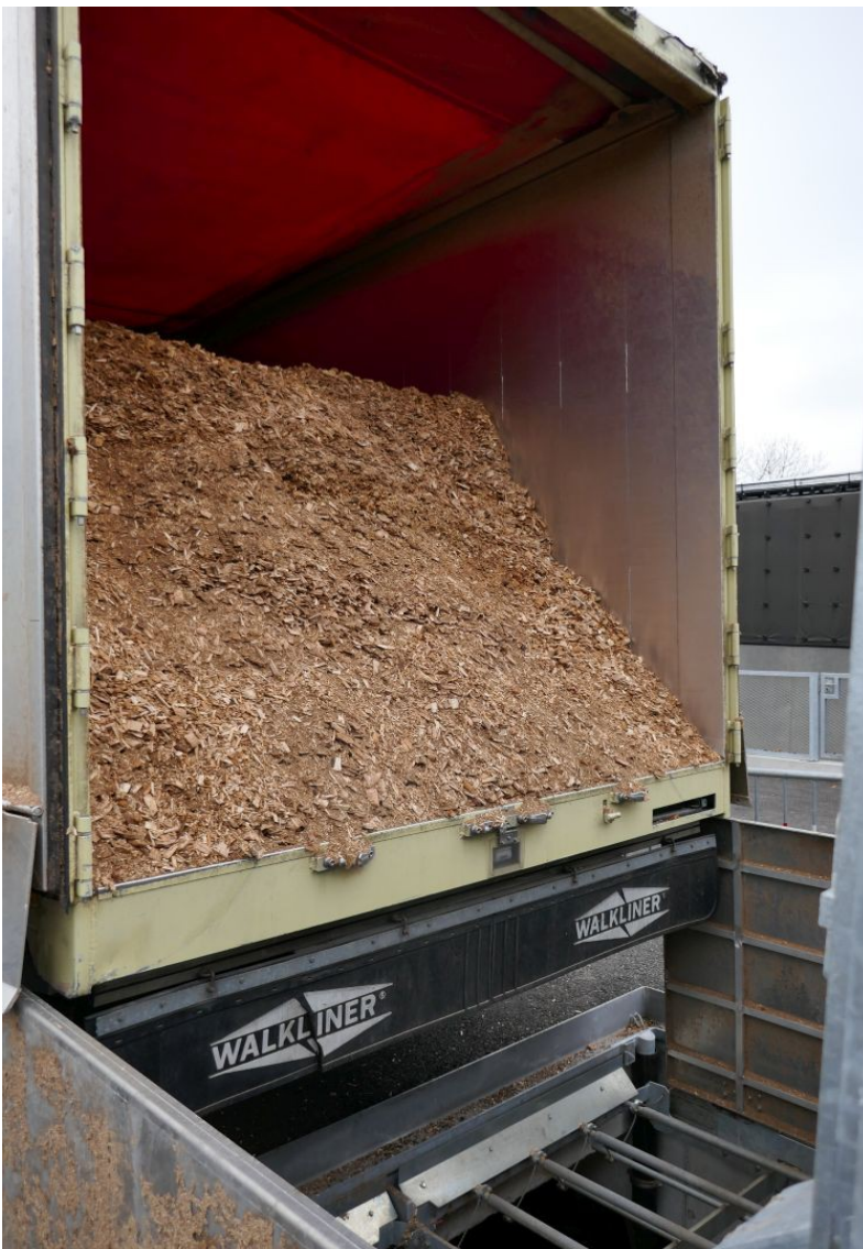
Die Schnitzel werden vom LKW in den Bunker geschoben.
