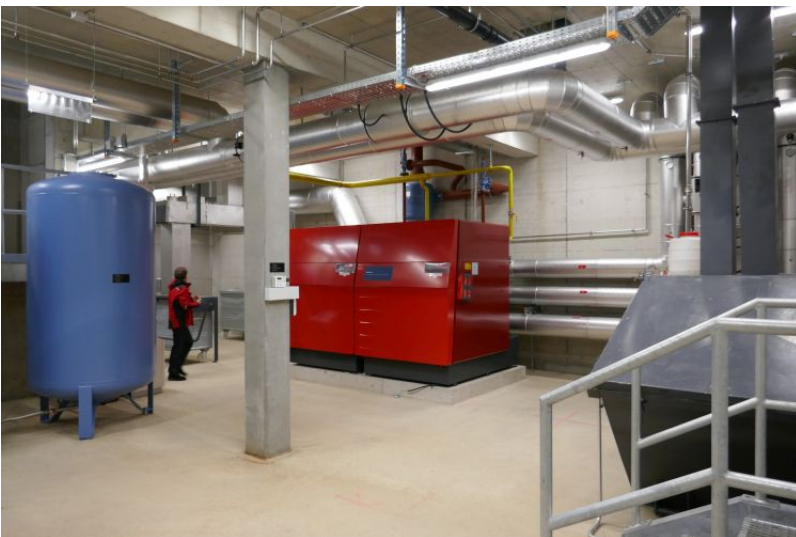
2 Gasheizungen (bei Ausfall der Schnitzelheizung)
