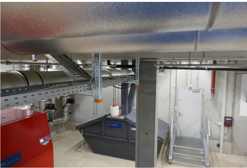
Hinter der Tür liegt der Schnitzelbunker
